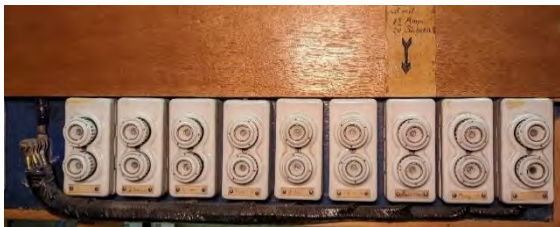
Veraltete Elektroinstallationen mit offenen Teilen
